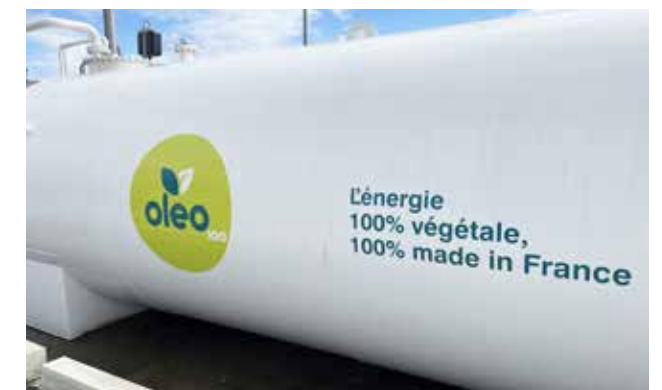
Cuve de B100 installée au quai de transfert de Dreux.
